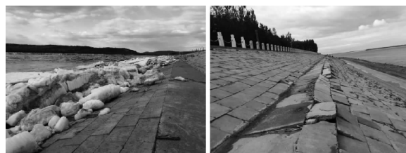
(a) 护岸抵抗冰排撞击 (b) 混凝土板护坡冻胀隆起
