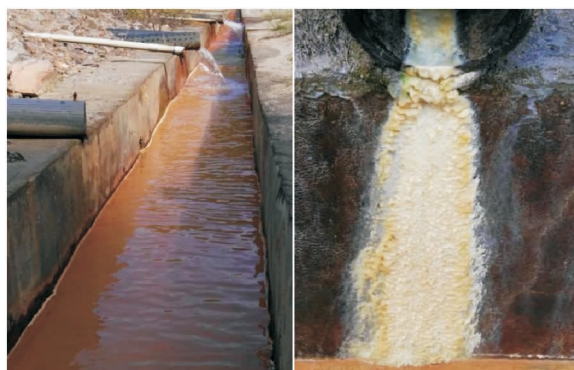
图1 石板沟尾矿库下游排水沟及排水管钙化沉淀物现场图 [17]
