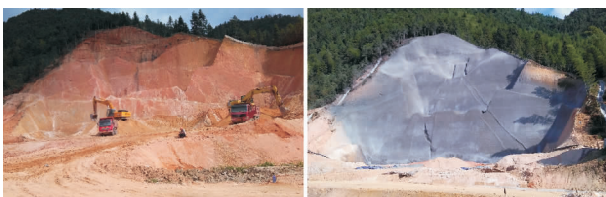
(a)左坝段坝基全风化花岗岩 (b)左坝段坝基全风化花岗岩喷锚支护
