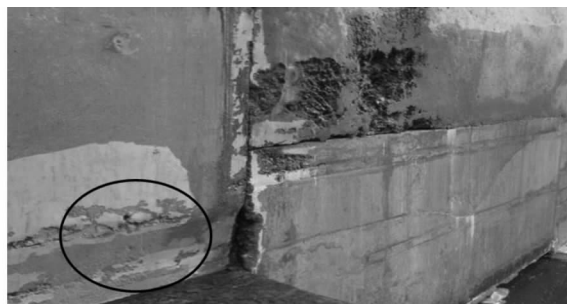
图10 2-2断面附近侧壁破坏照片
