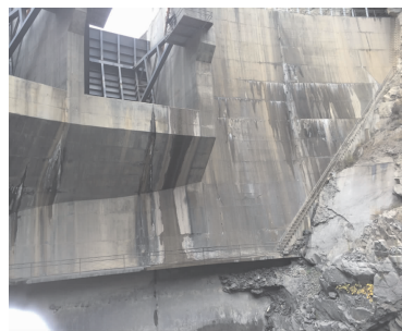
图 3 大坝左岸下游面渗漏现状图
