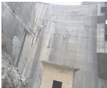
图 2 大坝右岸下游面渗漏现状图
