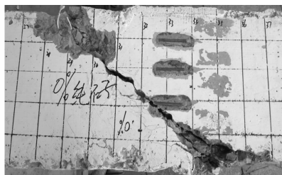
L 1 梁的破坏情况
