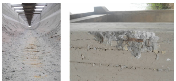
图 7 槽身剥蚀钢筋外露
